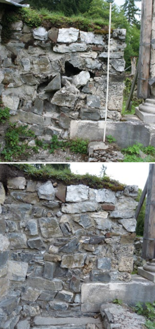
Zungenmauer an der Westseite des an der Südmauer der Kirche befindlichen Grabes vor (links) und nach (rechts) der Restaurierung
