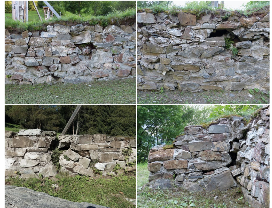
Typische Schadensbilder in unterschiedlichen Bereichen der Kirche vor Beginn der Restaurierungsarbeiten 2017
